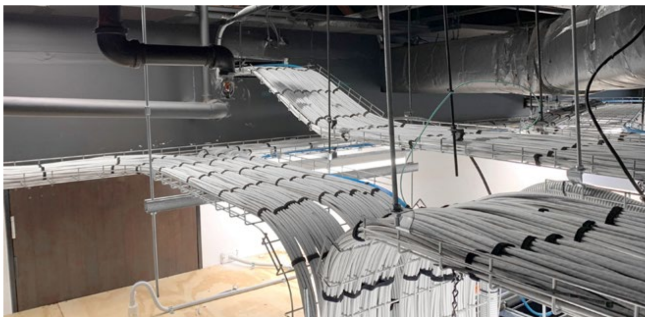
Fig. 4: Chemins de câbles ouverts
