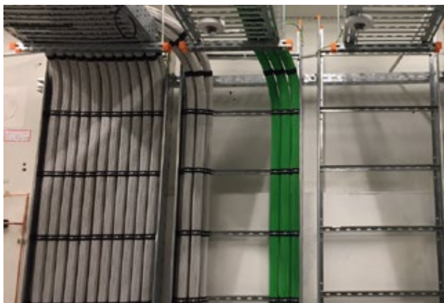
Fig. 6: Guidage des câbles dans une colonne montante
